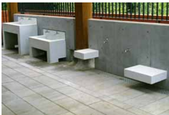
高さの異なる水道施設の例：
